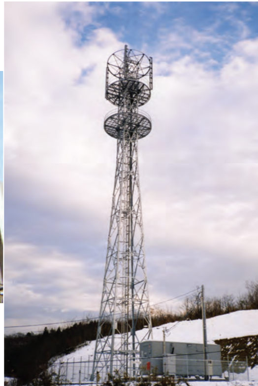
NTTコム殿向 通信鉄塔
